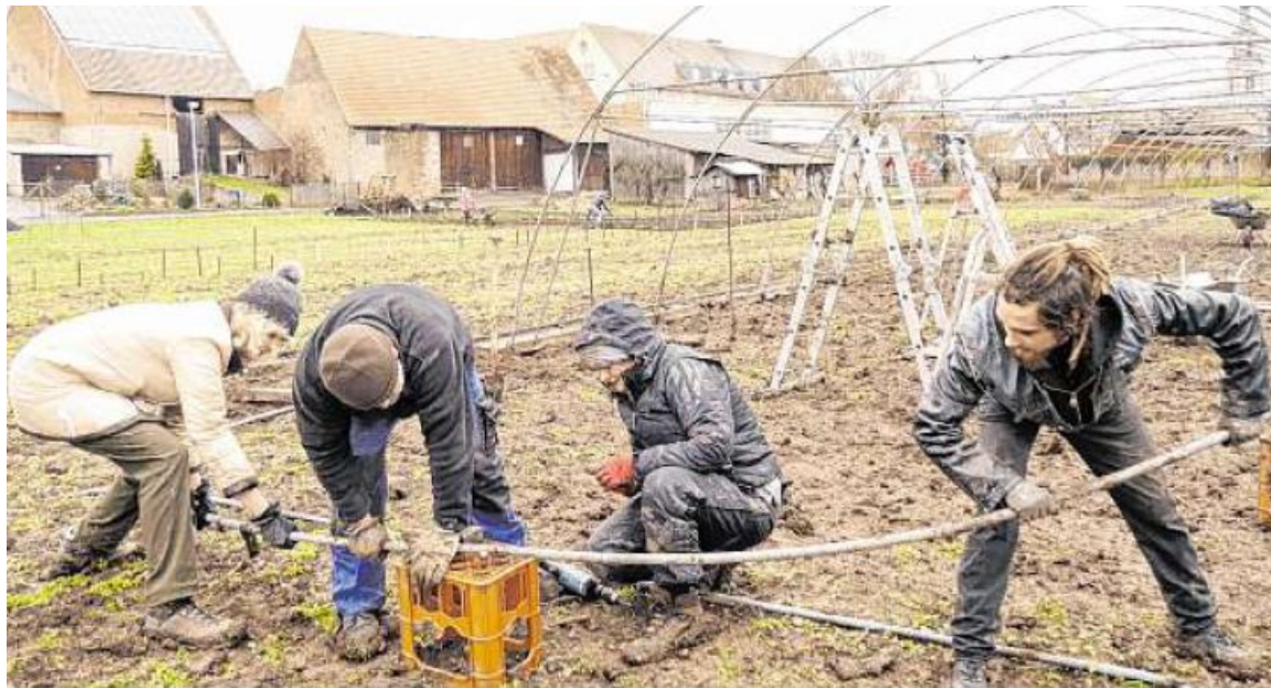
Der Verein hat die Bögen raus: Es geht voran mit dem Aufbau der SoLaWi-Gewächshäuser am Rand von Bergheinfeld. FOTO: UWE EICHLER
